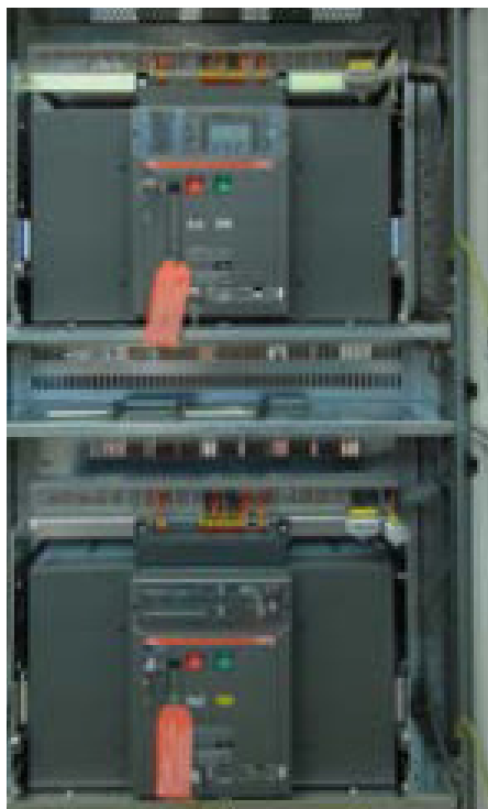
Quadro POWER CENTER serie LVS, interruttori di arrivo e congiuntore su quadro 4000A 50 KA POWER CENTER switchboard series LVS, limit switch and connector on 4000A 50 KA
