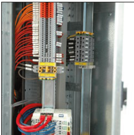
MODUL200E serie "G" vano cavi per connessioni circuiti ausiliari, di potenza e interconnessione sistema "SCADA"
