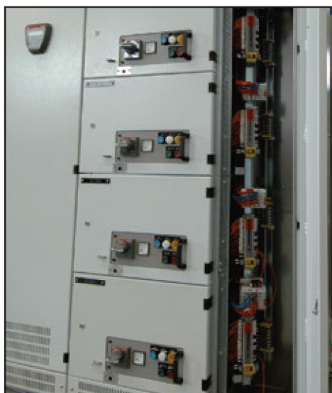
MODUL200E serie "G" particolare connessioni circuiti ausiliari, circuiti potenza e periferiche per connessioni sistema "SCADA"
