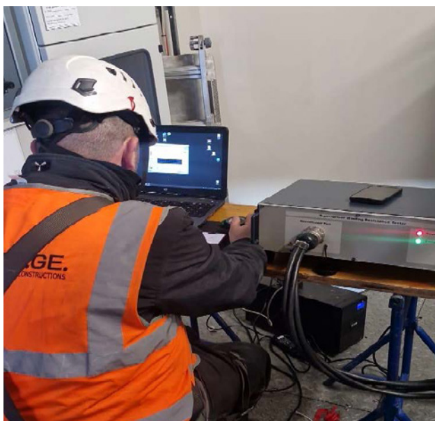
Test elettrici predittivi sui trasformatori delle turbine eoliche Predictive electrical testing on wind turbine transformers
