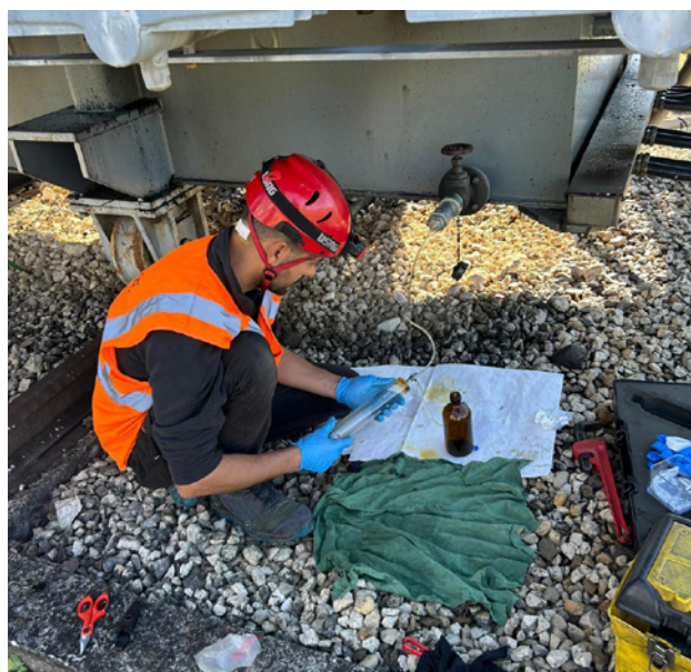
Prelievo di campioni di olio dal trasformatore Taking oil samples from the transformer
