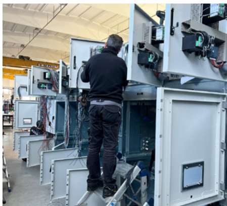
Cablaggio su quadro di media tensione Wiring on medium voltage panel
