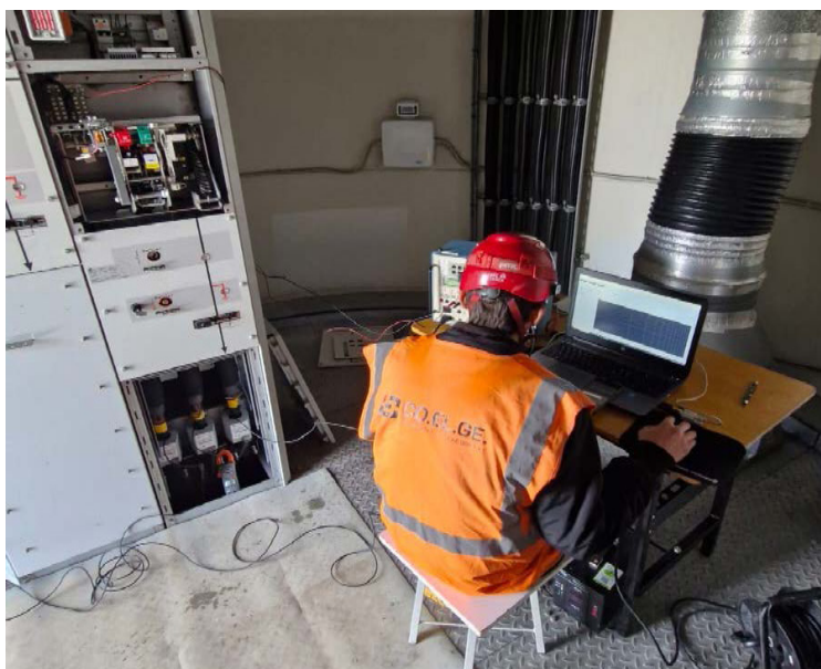
Test dei relè di protezione dei trasformatori nelle turbine eoliche Testing of transformer protection relays in wind turbines
