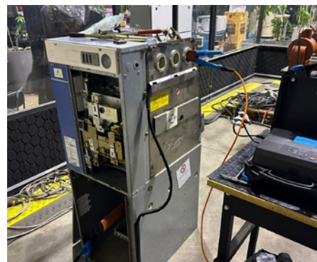
Test del quadro elettrico Electrical panel test
