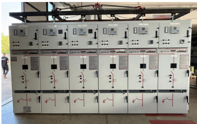
Quadro elettrico blindato a media tensione Medium voltage armoured switchboard
